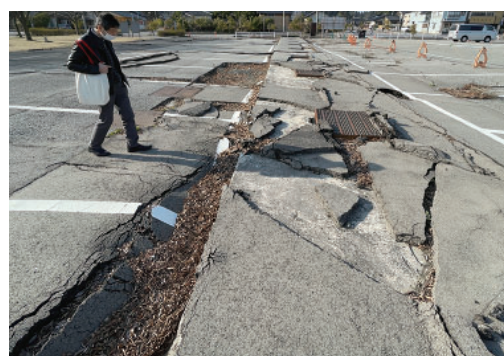
いまだ復旧されていない道路
