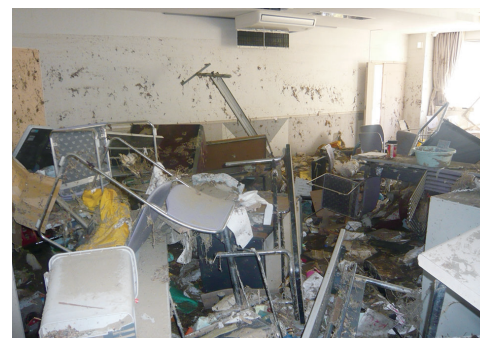
津波が天井近くまで入った のぞみ福祉作業所の施設内部
