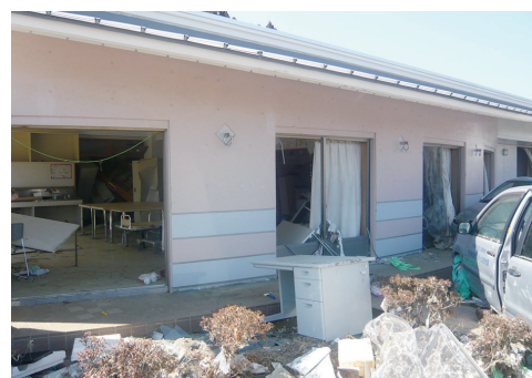
被災直後ののぞみ福祉作業所
